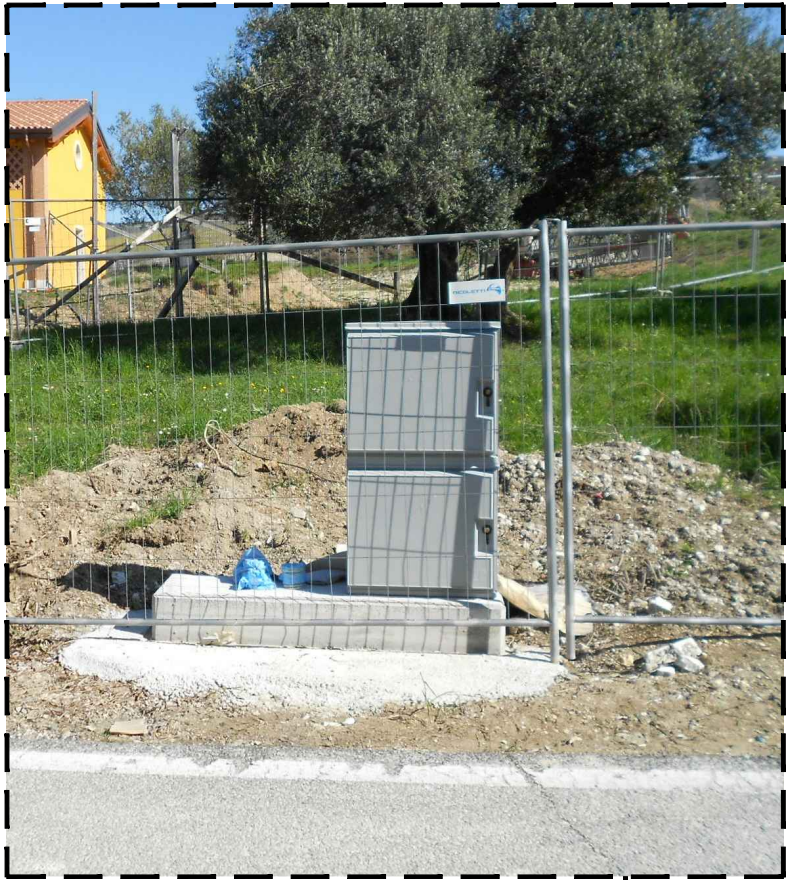
POZZETTO E CONTATORI RETE ELETTRICA
